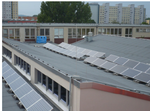
Blick auf den mittleren Teil der PV-Anlage auf dem Dach der Grundschule Am Pappelhain. Im Hintergrund zu sehen ist der noch zu sanierende Westflügel. Foto © 30°-SOLAR GmbH
