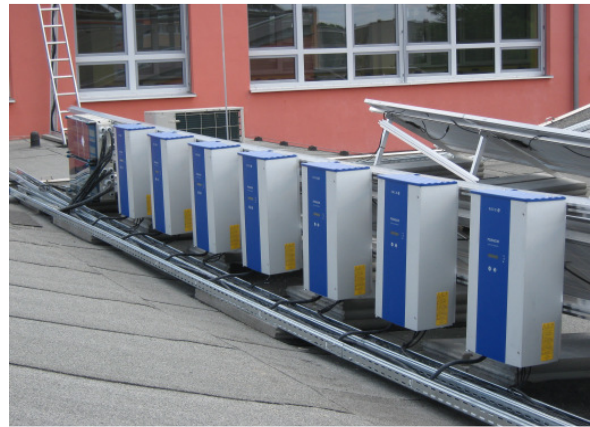
Powador-Wechselrichter der KACO new energy GmbH wandeln den Gleichstrom des Projekts PV-ANLAGEN CAMPUS STERN in Wechselstrom um und speisen ihn ins öffentliche Stromnetz ein. → Foto © 30°-SOLAR GmbH
