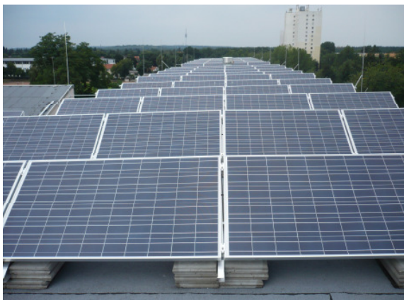
Die Photovoltaik-Anlage auf dem Dach der Grundschule Am Pappelhain im Potsdamer Ortsteil Am Stern mit einer installierten PV-Leistung von 34 Kilowatt peak . Foto © 30°-SOLAR GmbH
