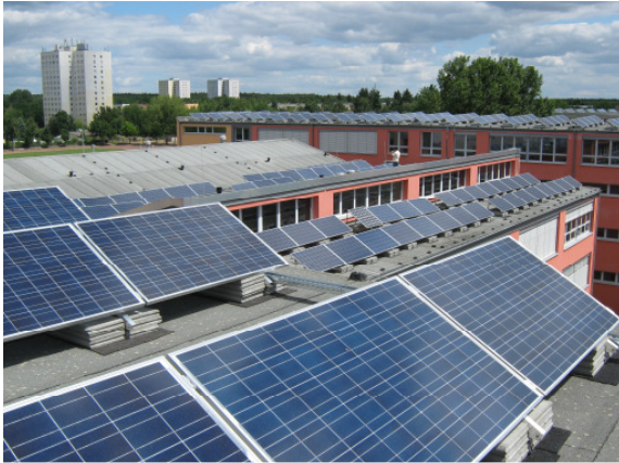
Die Photovoltaik-Anlage auf dem Dach des Leibniz-Gymnasiums im Potsdamer Ortsteil Am Stern mit einer installierten PV-Leistung von 54 Kilowatt peak . Foto © 30°-SOLAR GmbH
