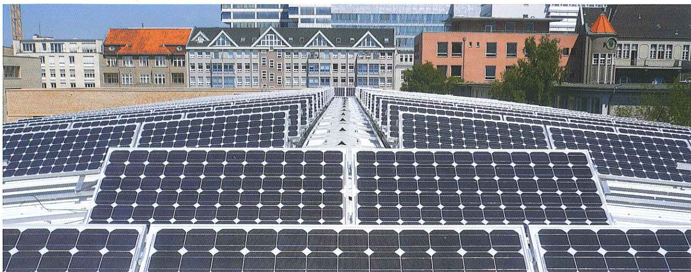
Die Photovoltaikanlage auf dem Dach der Friedensburg-Oberschule wurde im Sommer 2009 in Betrieb genommen und hat eine PV-Leistung von 66,33 kWp.
