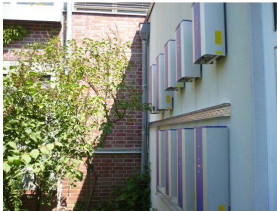
Powador-Wechselrichter von KACO new energy wandeln den Gleichstrom des SOLARSTROMPARKS BERLINER SCHULEN in Wechselstrom um und speisen ihn ins öffentliche Stromnetz ein.
