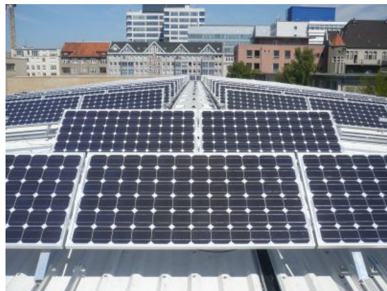
Die Photovoltaikanlage auf der Friedensburg-Oberschule im Berliner Bezirk Charlottenburg-Wilmersdorf mit 65 Kilowatt Leistung. Beide Fotos © 30°-SOLAR GmbH
